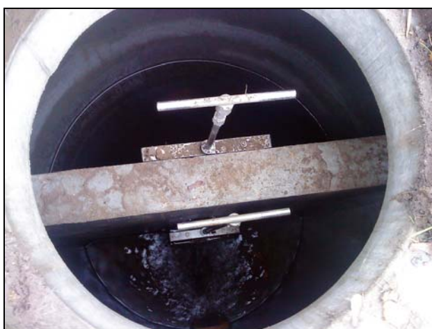
Udløbsbrønd med spjæld.
